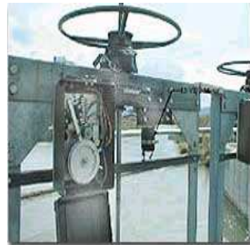
การติดตั้งเกียร์มอเตอร์ DC 12 V. ร่วมกับโซ่ วัดระยะ การเปิดบานประตูระบายน้ำพร้อมกัลลิมิตสวิทช์
