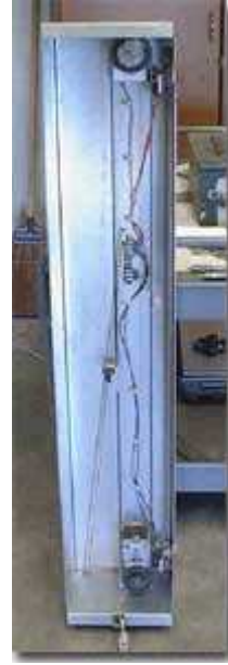
อุปกรณ์วัดระยะการเปิดบานประตูระบายน้ำพร้อม กัลลิมิตสวิทช์ป้องกันการเปิด-ปิดประตูผิดพลาด
